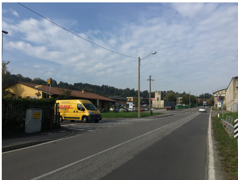
Immagine 3 – Linea aerea in corrispondenza dell'intersezione con via delle Industrie (Foto 5 elaborato G.3)
